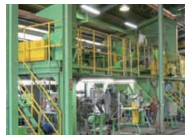
テスト工場内部
